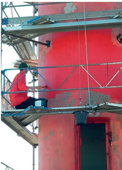
En dimmig majdag var ställningen uppe. Tvätt, spackling av sprickor och primer på rå betong färdigt. Nu kunde målningen starta...
