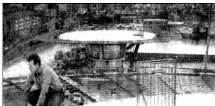
Bror Martinsson kontrollerar en elarmatur på helikopterplattan på kassunfyren Brandskärs flak. I bakgrunden syns toppen på kassunfyren Dynabrott.
