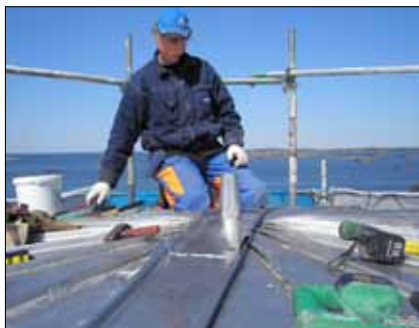
Det norra tornet har fått nytt plåttak. Profilen i mitten löper i nord-sydlig riktning, en liten plåtslagarfiness.
